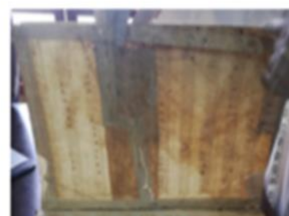
Figura 17. Amarillamiento, manchas de humedad e intervenciones anteriores.
